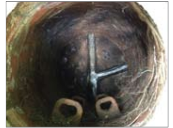
zu sanierender Schacht
